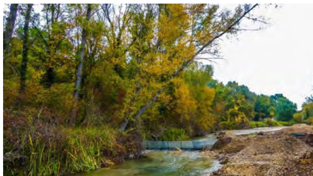
Chantier de restauration des caractéristiques hydromorphologiques du Colostre du Verdon et de restitution d'un milieu ouvert pour la faune et la flore réalisé par Spie batignolles valérian.
